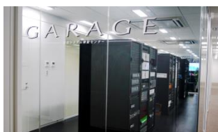
最新ソリューションを検証できる複合システム検証センター「GARAGE」
